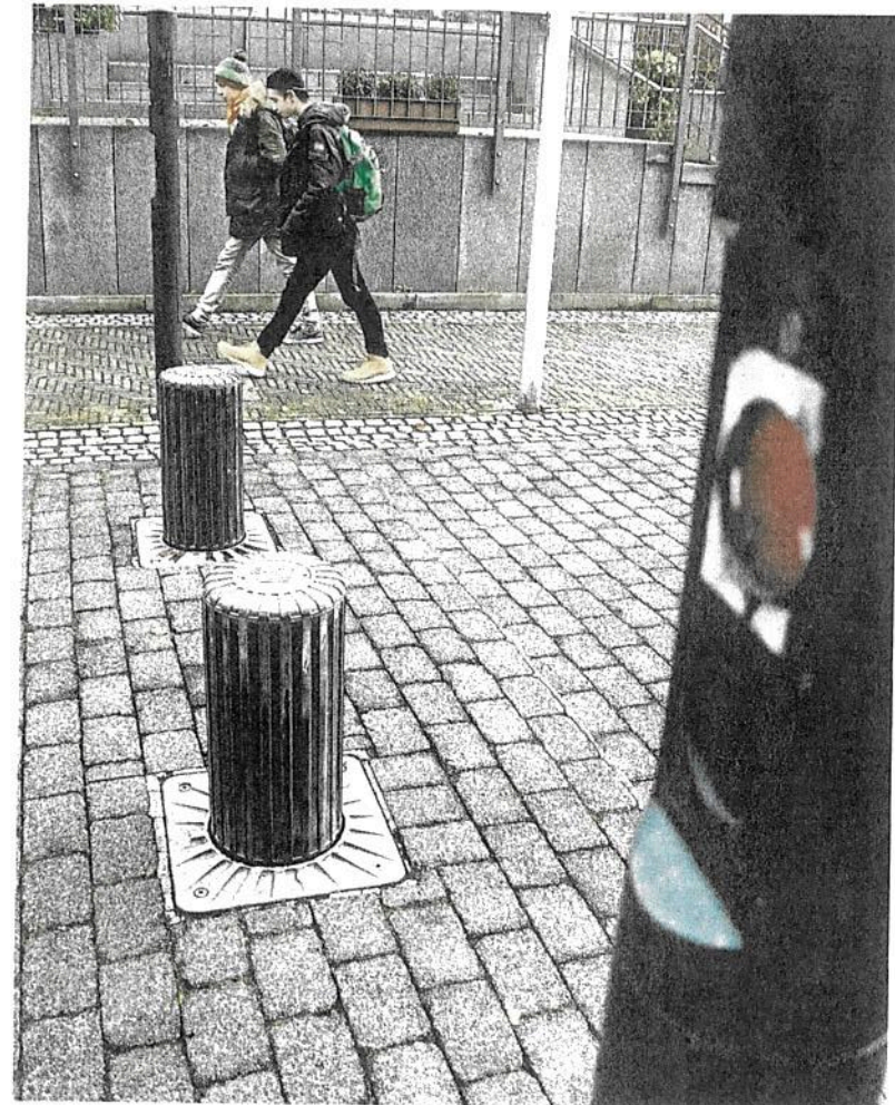
Die Poller an der Bahnstraße zur Einmündung Gartenstraße müssen erneuert werden.
